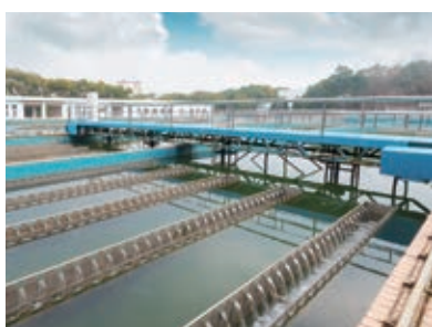
浄水場のろ過材に
